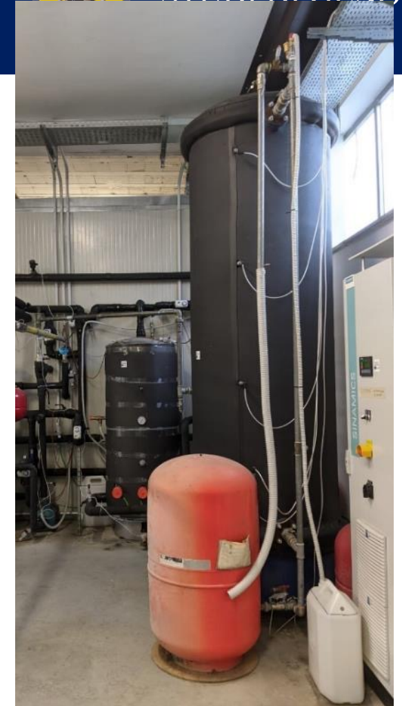
Accumulo termico a cambiamento di fase
